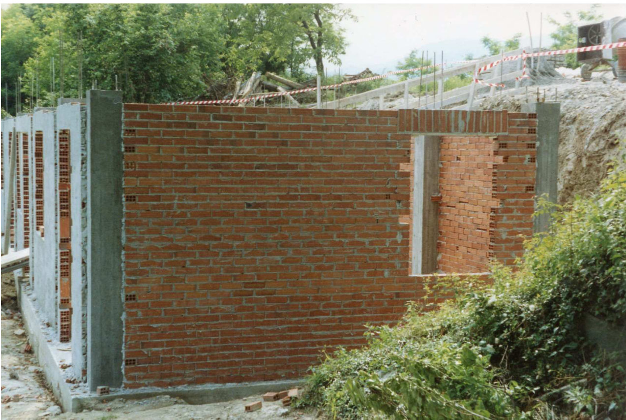
RE18 – la struttura abbandonata oggetto di demolizione e parzialmente ricostruita, all'epoca della sospensione dei lavori da parte del Comune
